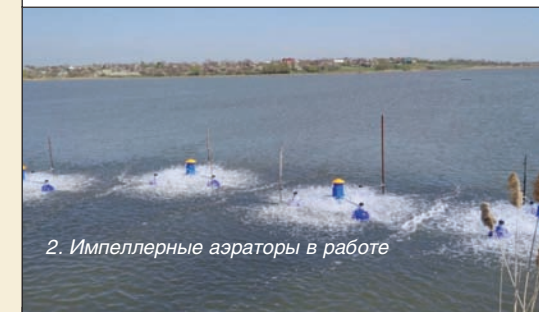
2. Импеллерные аэраторы в работе
